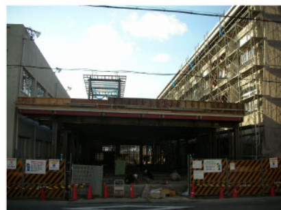
北棟、南棟の間に作られる、平屋の環境学習センター。屋上は緑化の予定。(工事中)
