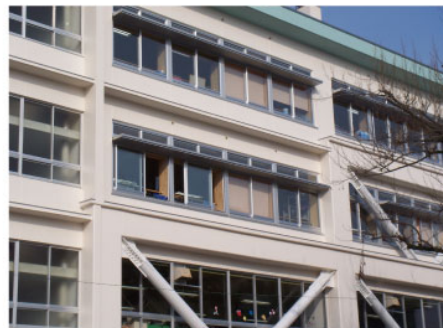
夏の日射遮蔽と室内へ自然光を入れるために、庇兼ライトシェルフを設置。
