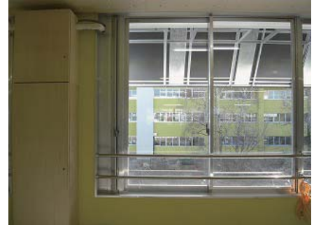
教室のサッシの一部には、夜間換気・通風促進用にガラリを設置。
