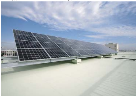
普通教室棟の屋上に設置した太陽光発電パネル（10kW）
