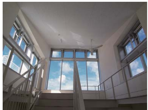
階段室上部に自動開閉装置付き排気用窓を設置。
