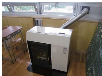
地域バイオマス資源を活用するペレットストーブ。
