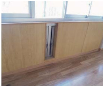
普通教室や廊下に新しく付けた給気用スリット。
